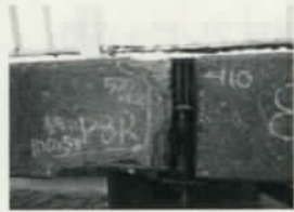
【地覆】断面欠損
