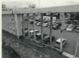
【高欄・防護柵】破断
