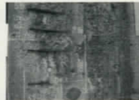
【下部構造】鉄筋露出
